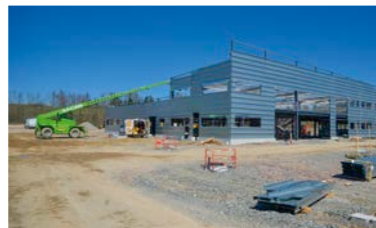
Les nouveaux locaux d'ENEDIS - GRDF, en cours de construction, accueilleront près d'une centaine de salariés.
