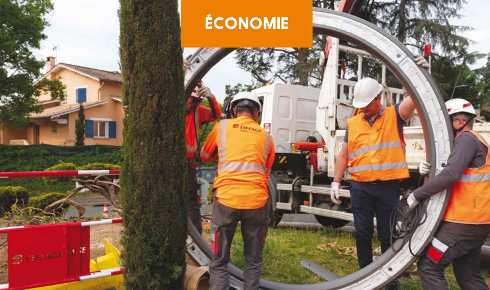
© Eiffage Energie Systèmes
