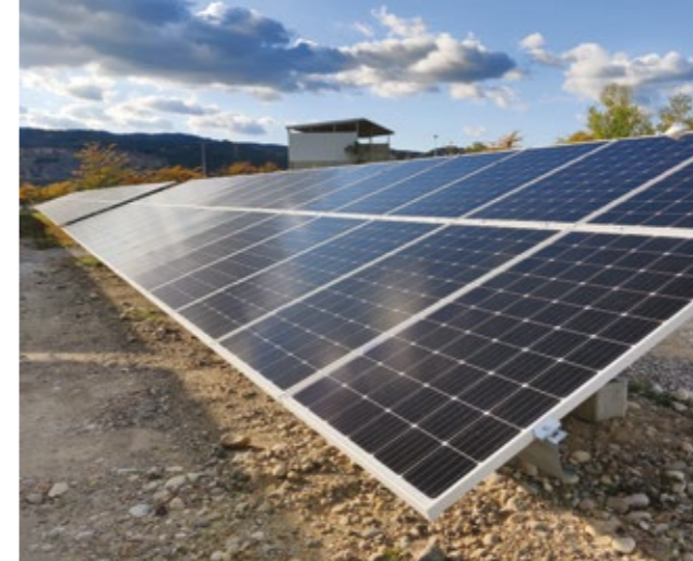
© Eiffage Energie Systèmes
